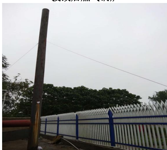
15m 高排气筒
