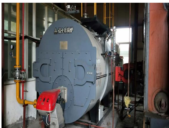
新建燃气锅炉
