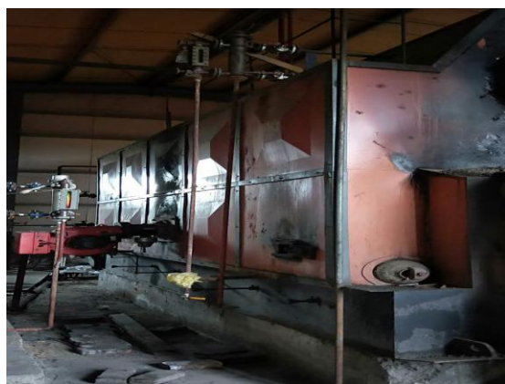
技改后燃气锅炉
